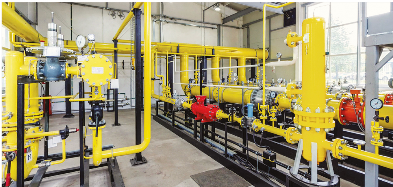
ГРП «Тёплый Стан», ОАО «Мосгаз» (г. Москва)
