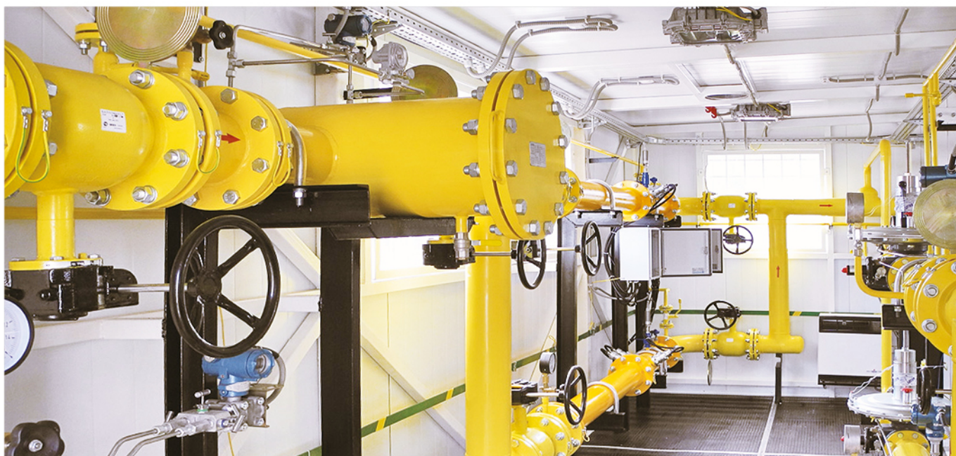
ГРПБ для завода ЗАО НПО «Тяжпромарматура» (г. Алексин, Тульская обл.)
