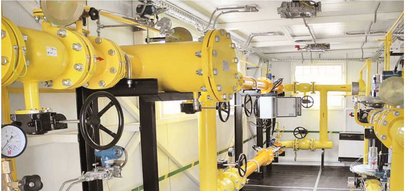
ГРПБ для завода ЗАО НПО «Тяжпромартуратура» (г. Алексин, Тульская обл.)
