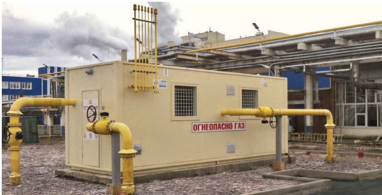
ГРПБ для завода Procter&Gamble (г. Новомосковск)
