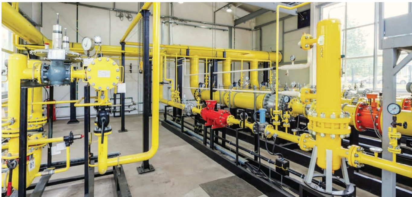
ГРП «Тёплый Стан», ОАО «Мосгаз» (г. Москва)
